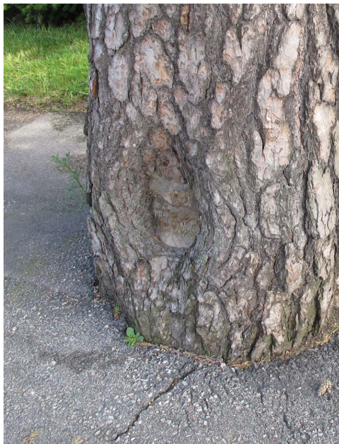
Då träd placeras fel eller vägarna byggs för nära dess stammar är sannolikheten stor att de skadas vid snöröjning.
